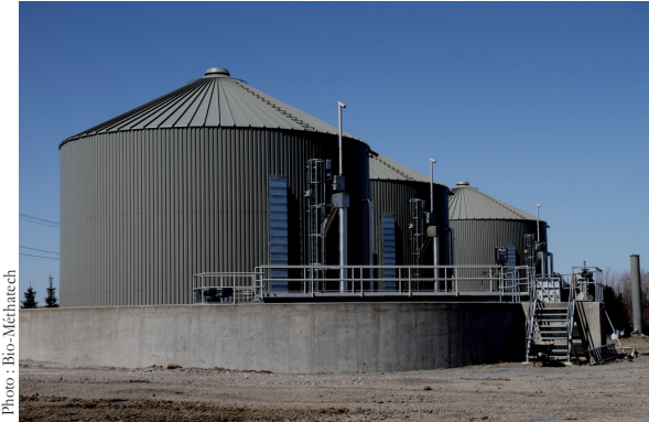
Les installations de bio-méthanisation de la compagnie québécoise Bio-Méthatech près de la station d'épuration des eaux usées à St-Hyacinthe.
